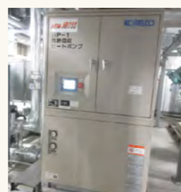
北埼玉工場へ導入した廃熱回収ヒートポンプ
