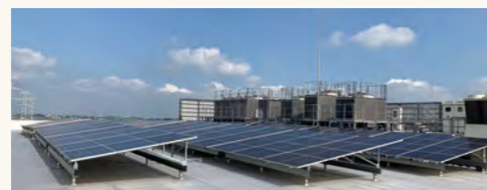
北埼玉工場屋上に設置の太陽光発電システム
