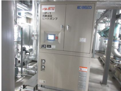
廃熱回収ヒートポンプ
