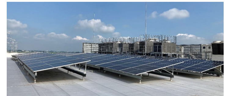
北埼玉工場の屋上太陽光発電システム
