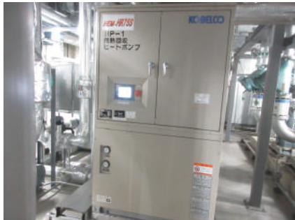
廃熱回収ヒートポンプ
