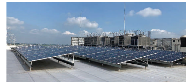
北埼玉工場の屋上太陽光発電システム
