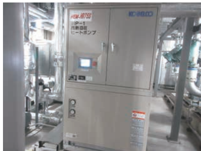
廃熱回収ヒートポンプ
