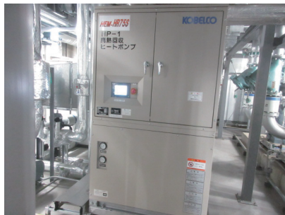
廃熱回収ヒートポンプ
