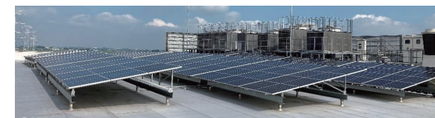
北埼玉工場の屋上太陽光発電システム
