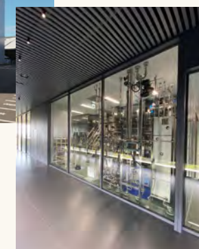
北埼玉工場2号棟注射製造ライン 見学者通路からの様子
